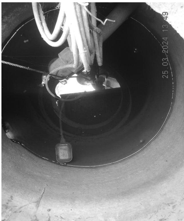
Рисунок 22 – улица Пушкина, 120 (колодец затоплен, перерезан провод питания насосного агрегата)
